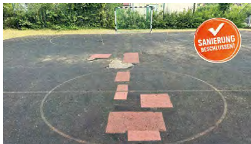
Der Allwetterplatz weist seit Jahren deutliche Schäden auf und war nur noch eingeschränkt nutzbar.
